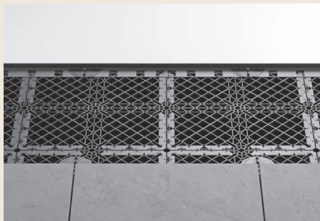
Positionnement du profilé sur les plots Positionierung des Randprofils auf den Gittern
